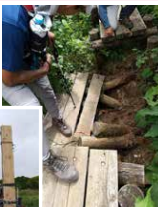
落下してしまった高層木道(釣鐘岩手前)
